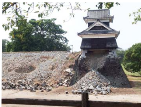
熊本城の櫓（石垣の崩落）
